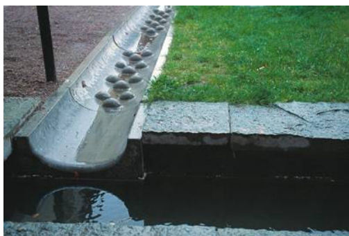
Vand-rende til nedsivning eller opsamling
